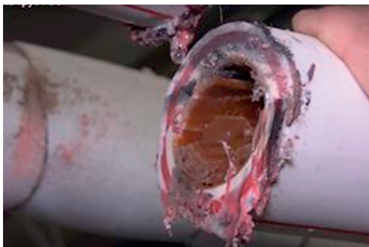
Рис. 1. Срез сетевой пластиковой трубы ГВС многоквартирного дома (г. Жуковский, Московская обл.)
