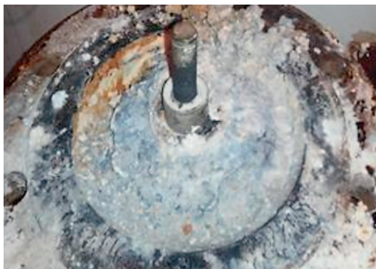
Рис. 5. Демонтированный из сети ГВС аппарат водоподготовки ЭХЗ «Эиран» с забитым накипью магниевым стержнем (г. Уфа)
