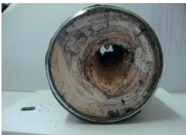
Рис. 3. Срез демонтированной трубы сетевого трубчатого теплообменника ГВС (г. Муром, Владимирская обл.)
