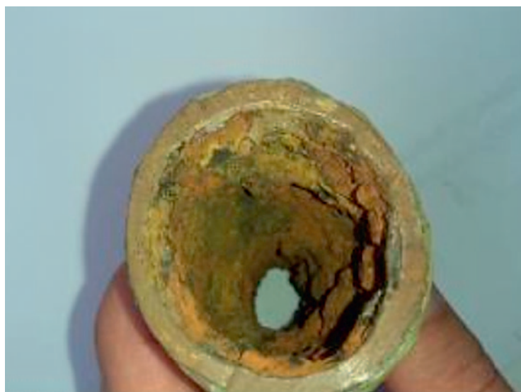
Рис. 4. Срез домовой трубы ГВС при наличии установки водоподготовки MWS на базе постоянных магнитов (г. Уфа)
